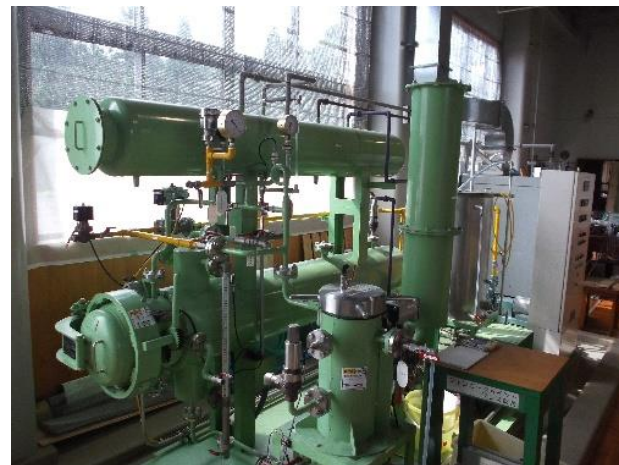
▲含浸薬剤の減圧加圧注入装置
