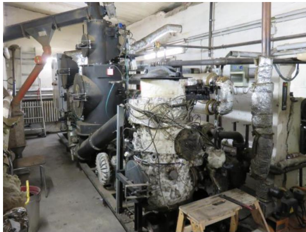
建設業者の工場内のCHP (45kW)
