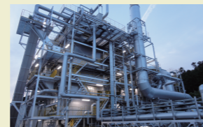
蒸気タービン発電機
