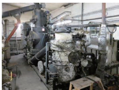
建設業者の工場内のCHP（45kW）
