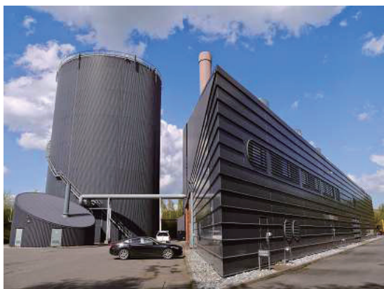
地域熱供給プラントの巨大な蓄熱槽
