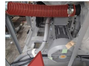
汎用エンジン (25kW × 2台)
