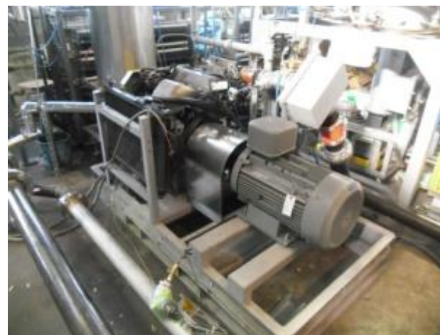
本システムで採用した エンジン発電機
