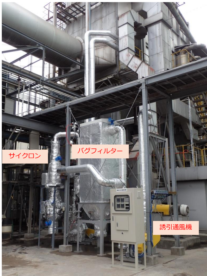
サイクロン実証試験設備全景
