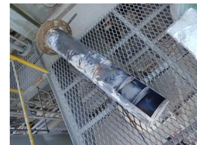
ガスの引き抜き配管
