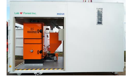
コンテナ式パッケージボイラ
