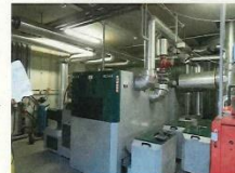
バイオマスボイラー
