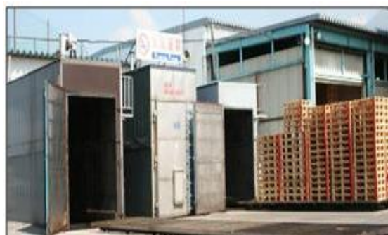
木材乾燥設備へ蒸気供給
