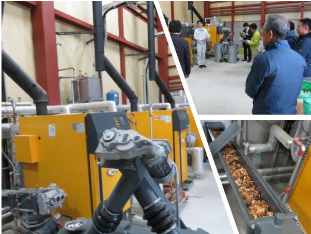
写真一 7 最上町若者定住モデルタウンのボイラー施設
