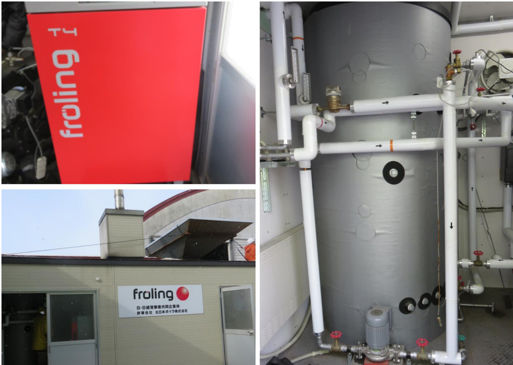
写真一 23 木質ボイラー施設（改造コンテナ）
