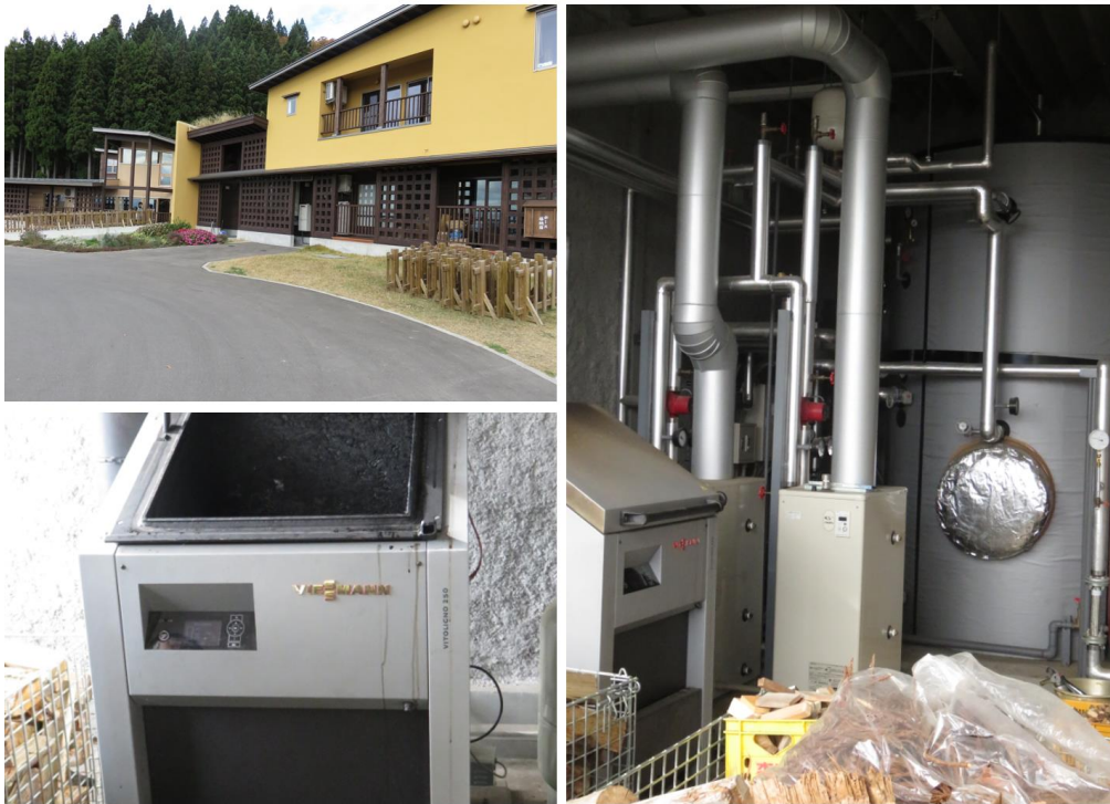
写真一 9 認定こども園めぐたまの全景と薪ボイラー
