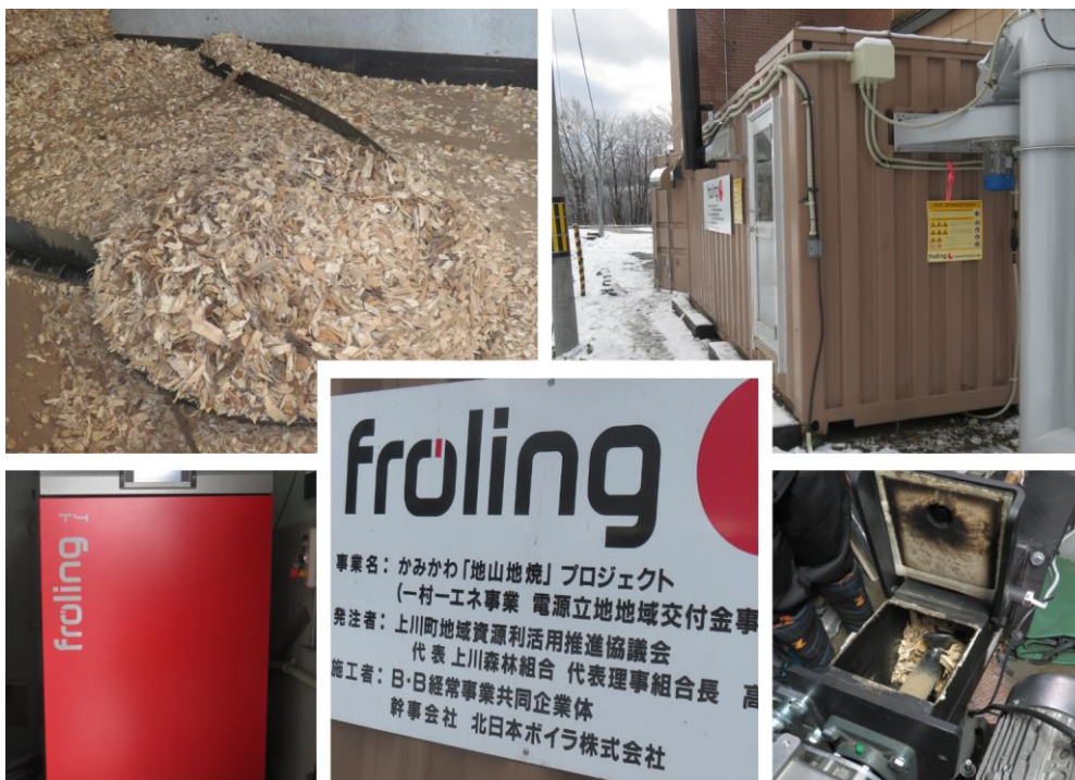
写真一 13 小椋組のボイラー施設（改造コンテナに設置）
