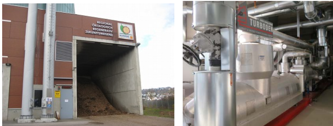
図-2.2 地域熱供給プラントに追加された熱電併給設備 (左：プラント建屋、右：ORC)
