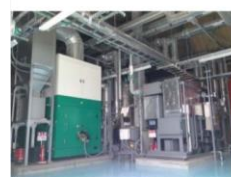
—チップボイラー—
