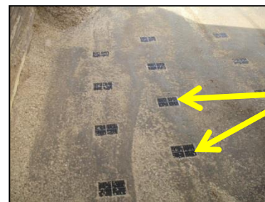
温風吹き出し口
